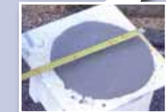
Fase 3 Cementificazione del foro, mediante introduzione di miscela cementizia a pressione (Betoncino RS 20, Betoncino RS 30 e Betoncino RS 40) a partire dal fondo del palo fino alla bocca del foro. Con la risalita i detriti residuali vengono riportati a galla, a garanzia del completo riempimento del fusto.
